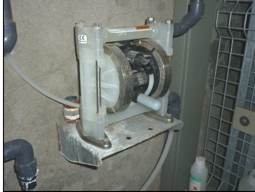
Sistema di dosaggio della soda caustica
